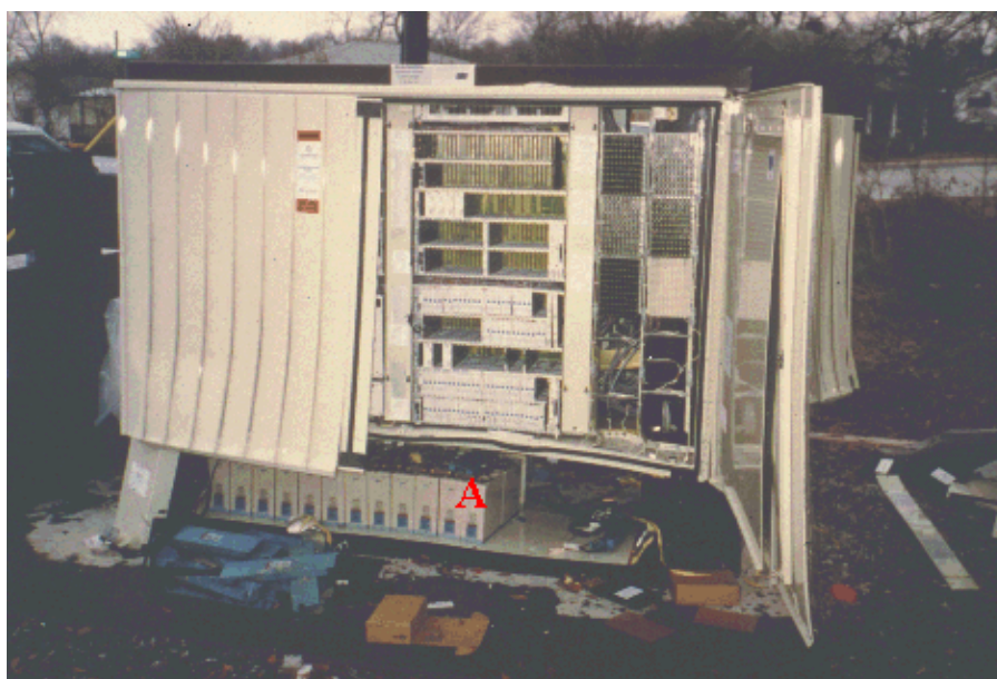
Ryc.1 Skutki eksplozji akumulatorów w wyniku rozbicia termicznego ogniów w szafie dostępowej.
