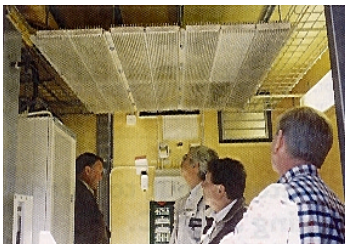
Ryc.2 Akumulatory ciepła ClimaSel firmy Climator w kontenerze GSM.
